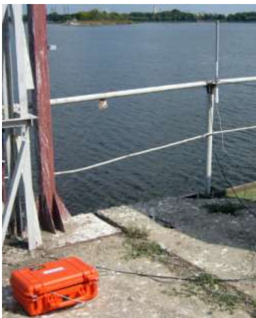
Контейнер и антенна беспроводной связи
