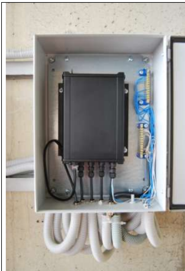
Шкаф с аппаратурой МПГНСС-4С
