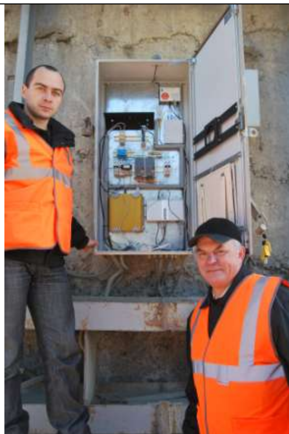
Шкаф со вспомогательным оборудованием
